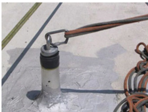
Figura 116 - Ponto de Ancoragem para Fixação de Cinto de Segurança
