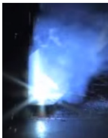
Figura 147 - Sem Exaustão de Fumos Metálicos
