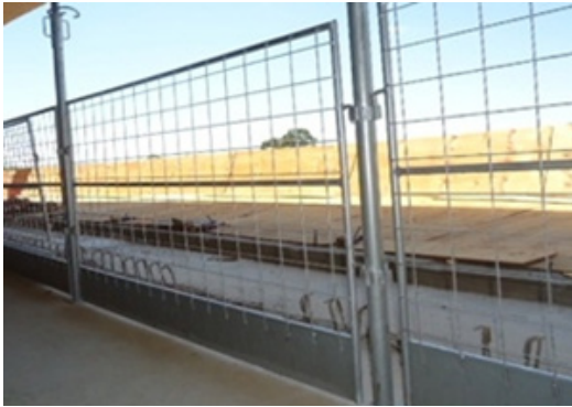
Figura 9 - Guarda-Corpo instalado em Laje Plana
