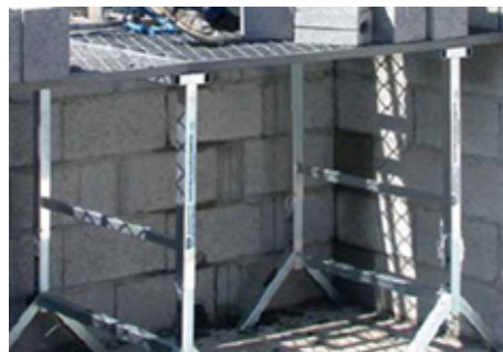
Figura 65 - Andaime Apoiado em Cavaletes
