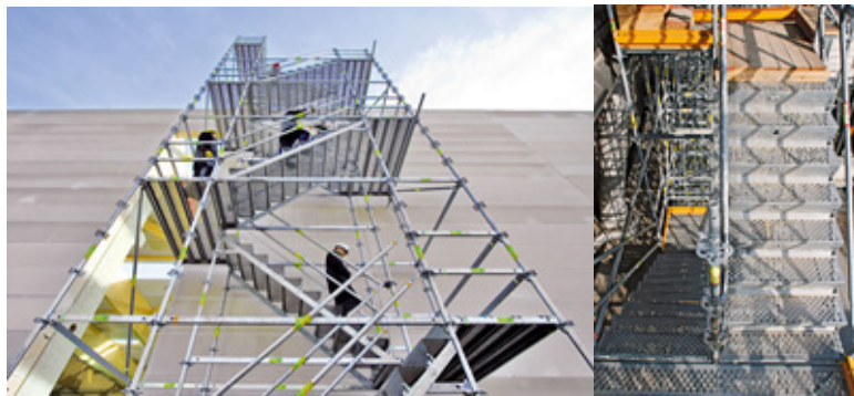
Figura 43 - Escadas em Torres (falta de tela lateral)
