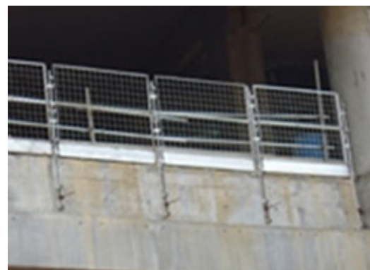
Figura 8 - Guarda-Corpo instalado em Viga de Periferia
