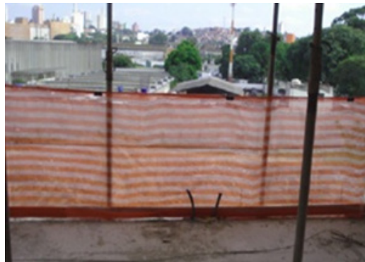
Figura 11 - Guarda-Corpo com Cabo de Aço em Laje
