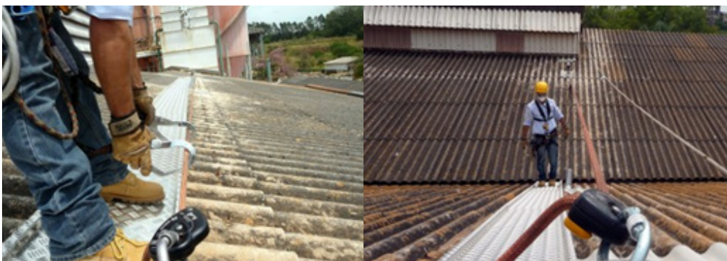
Figura 137 - Passarelas para Telhados
