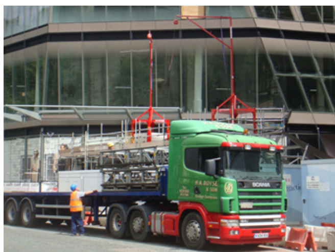
Figura 34 - Exemplo de Estrutura Fixa para Conexão de Cinto de Segurança
