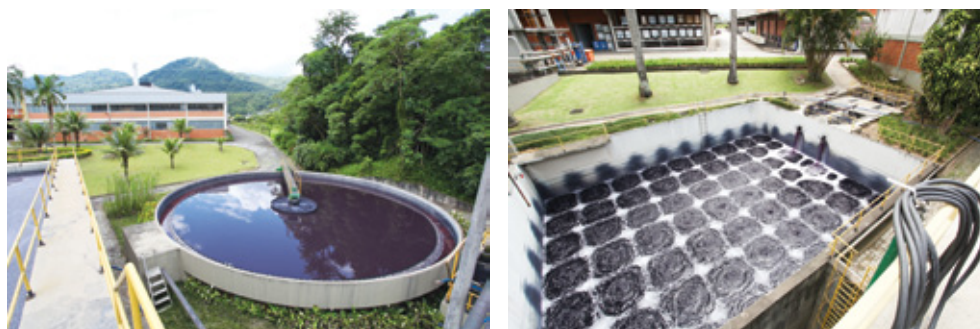
Estações de tratamento de efluentes. Fotos: Marisol/Divulgação.
