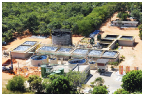
Sistema de tratamento de efluentes. Foto: Cedro Cachoeira/Divulgação.
