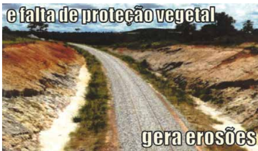
Figura 10 – Registros fotográficos da auditoria do TCU: proteção vegetal
