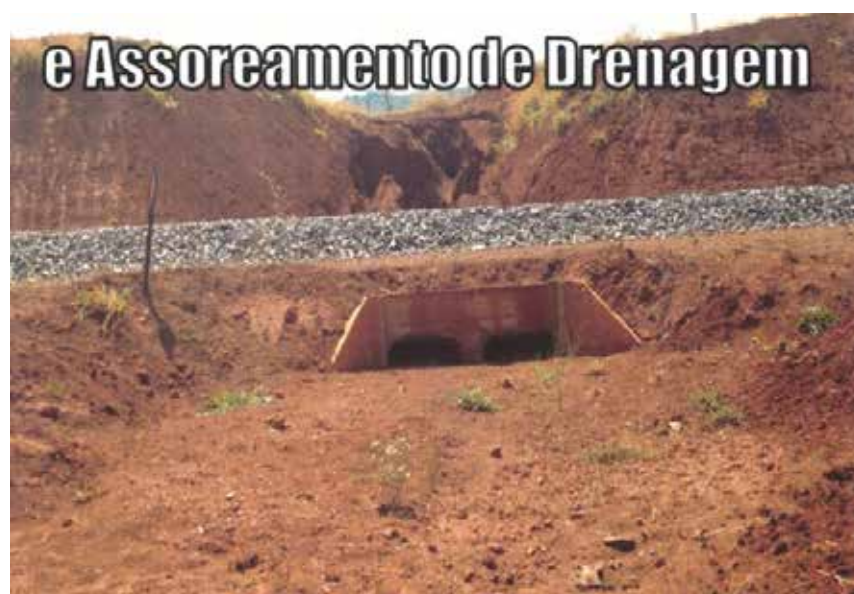
Figura 11 – Registros fotográficos da auditoria do TCU: proteção vegetal
