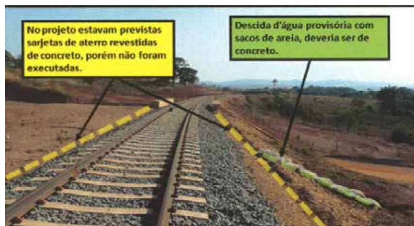
Figura 9 – Registros fotográficos da auditoria do TCU: sarjetas de aterro e descida d'água
