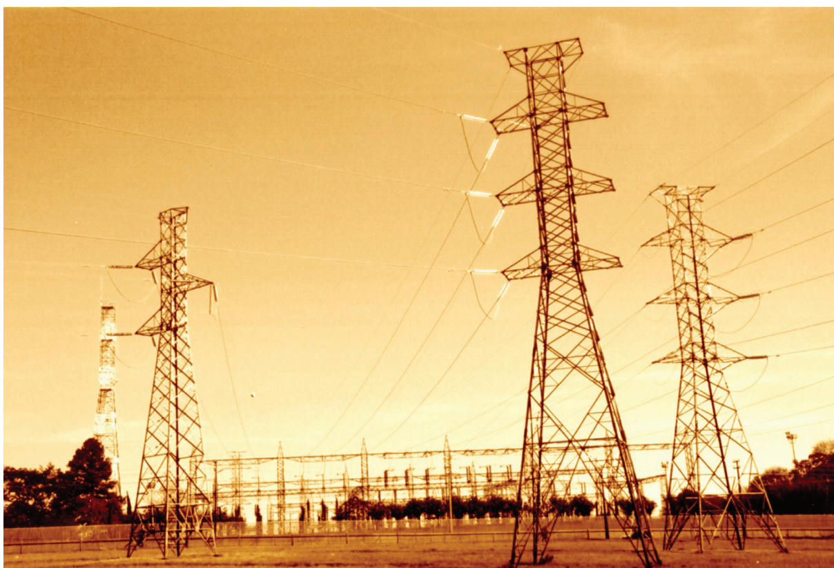
Figura 4 - Subestação e linha de transmissão da Copel, Paraná
