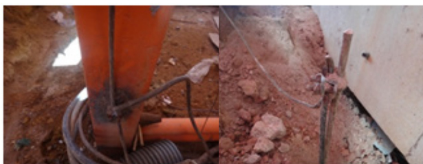
Figura 61 - Aterramento de Grua
