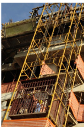
Figura 57 - Torre de Elevador à Cabo
